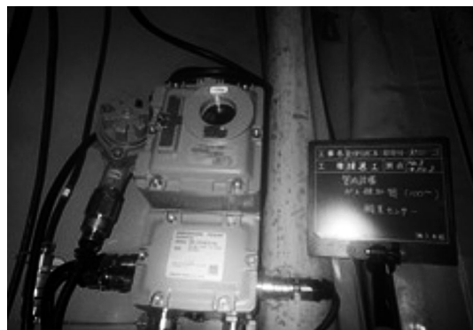
写真-3 定置式自動検知器（防爆構造）
