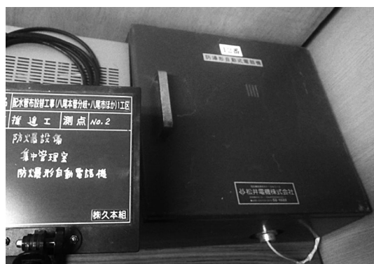
写真-6 通話装置：管理室
