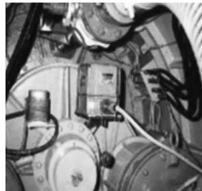
写真-10 管内動力自動遮断盤
