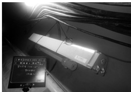
写真-4 非常用照明灯（防爆構造）
