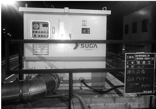
写真-7 換気設備（高圧ブロア37kw）
